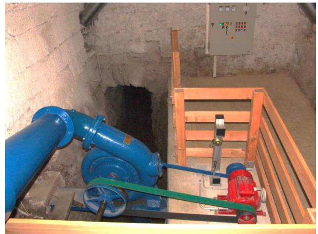
Abb. 2: Francisturbine Altbachmühle Wittnau.
