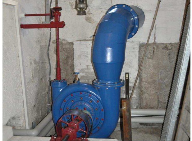
Abb. 5: Francisturbine Schlossmühle Schlossrued..
