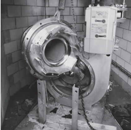
Leitapparat Francisturbine Mikrokraftwerk Obermüli Andelfingen, Anlage Nr. 57
