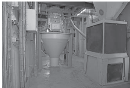
Les céréales sont transformées en aliments composés à l'aide d'installations modernes.
